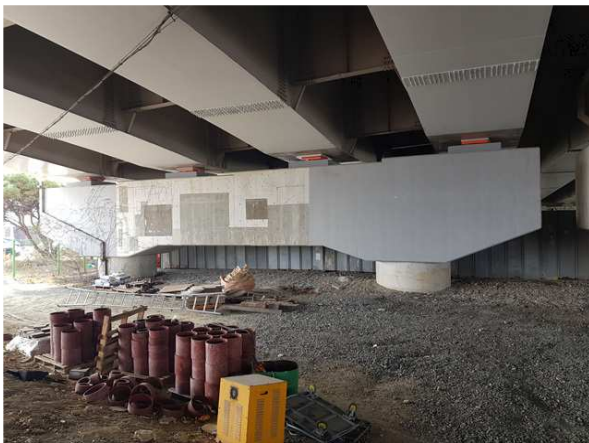
교각 P1 상태현황
