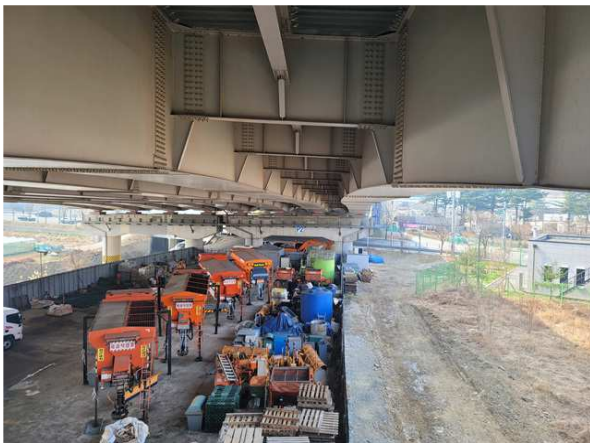
교각 P2 상태현황
