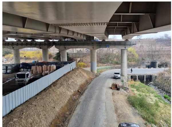
교각 P3 상태현황
