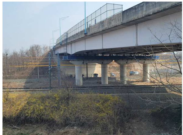
교각 P4 상태현황
